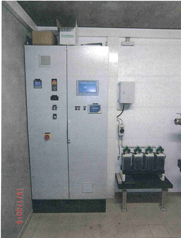
Elektro-, Steuerungs- und Fernwirktechnik
